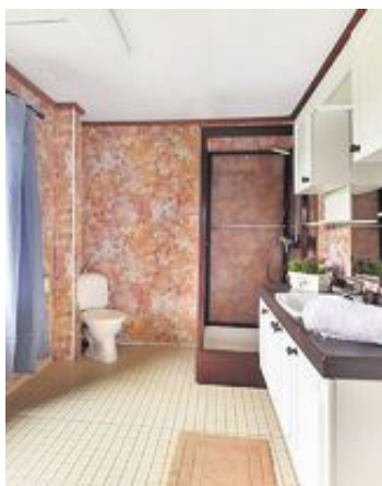
RESPATEX: Veggene på badet er dekket av respatexplater.
